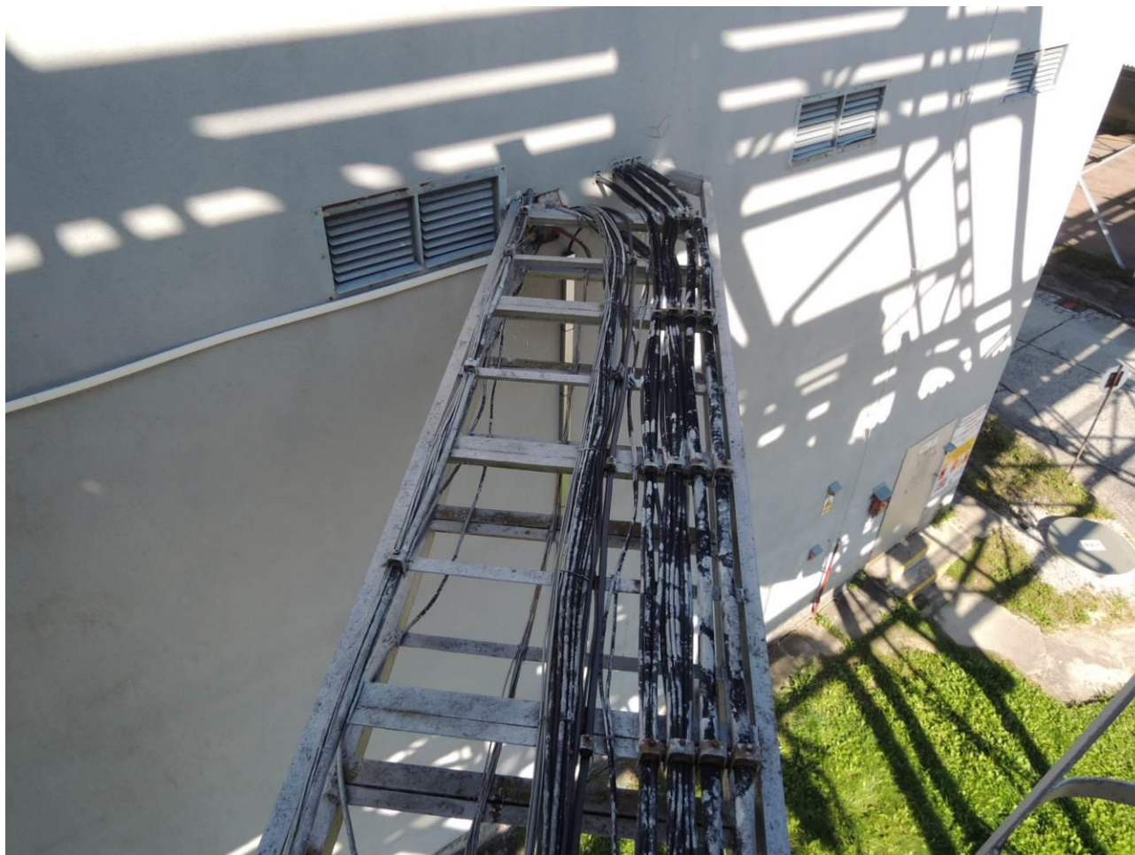
Stávající kabelový most do obj. 222.
