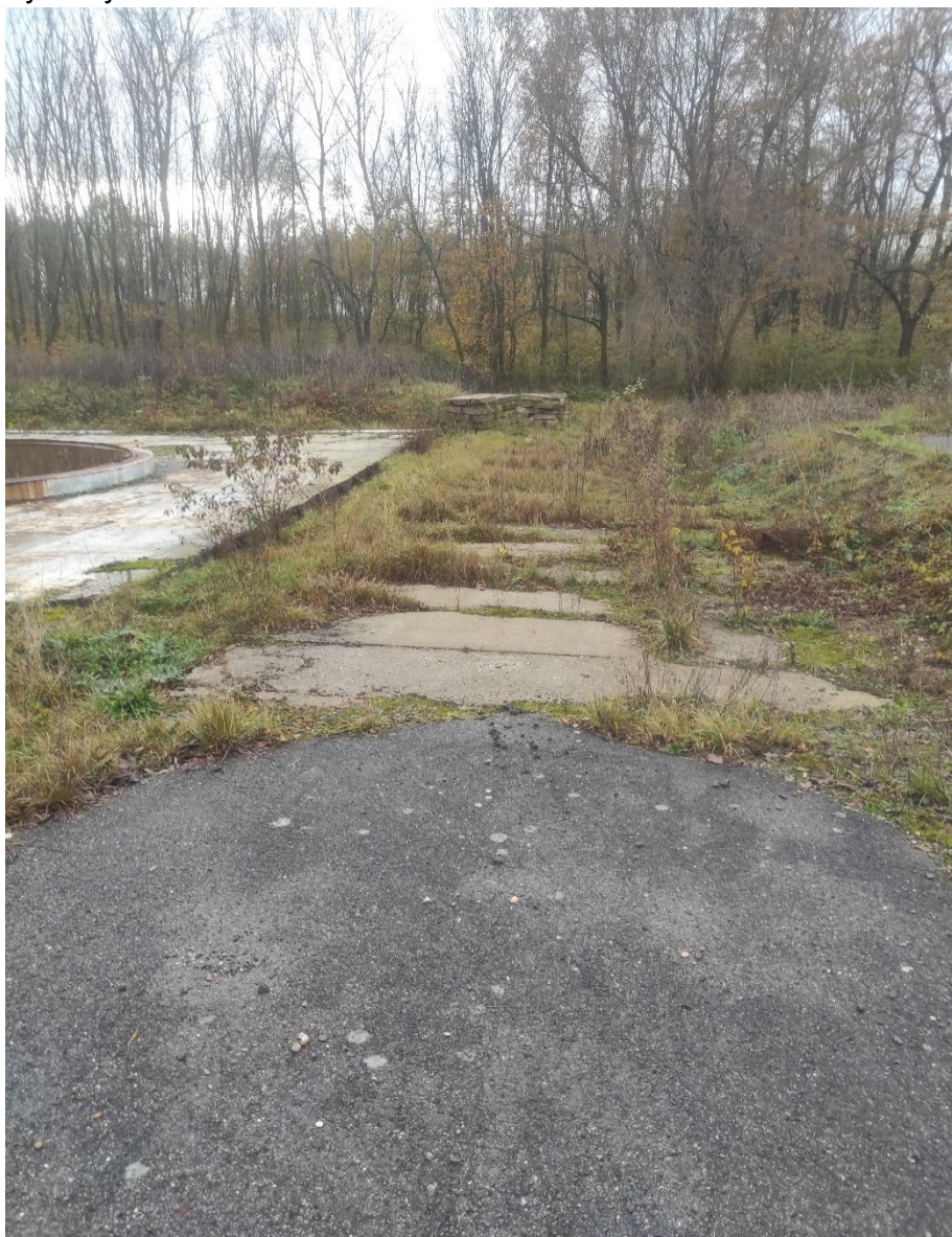
Výškový rozdíl v místě základů nádrží
